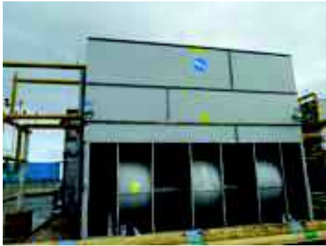
Figura 2. Torre di condensazione
