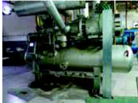
Figura 3. Compressore per ammoniaca
